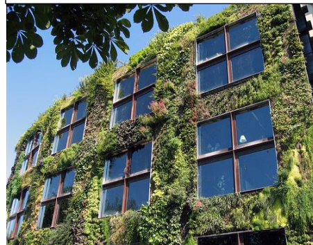
Exemple de mur végétal :
